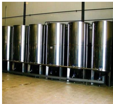
Cuve de décantation (Système traditionnel) 23
