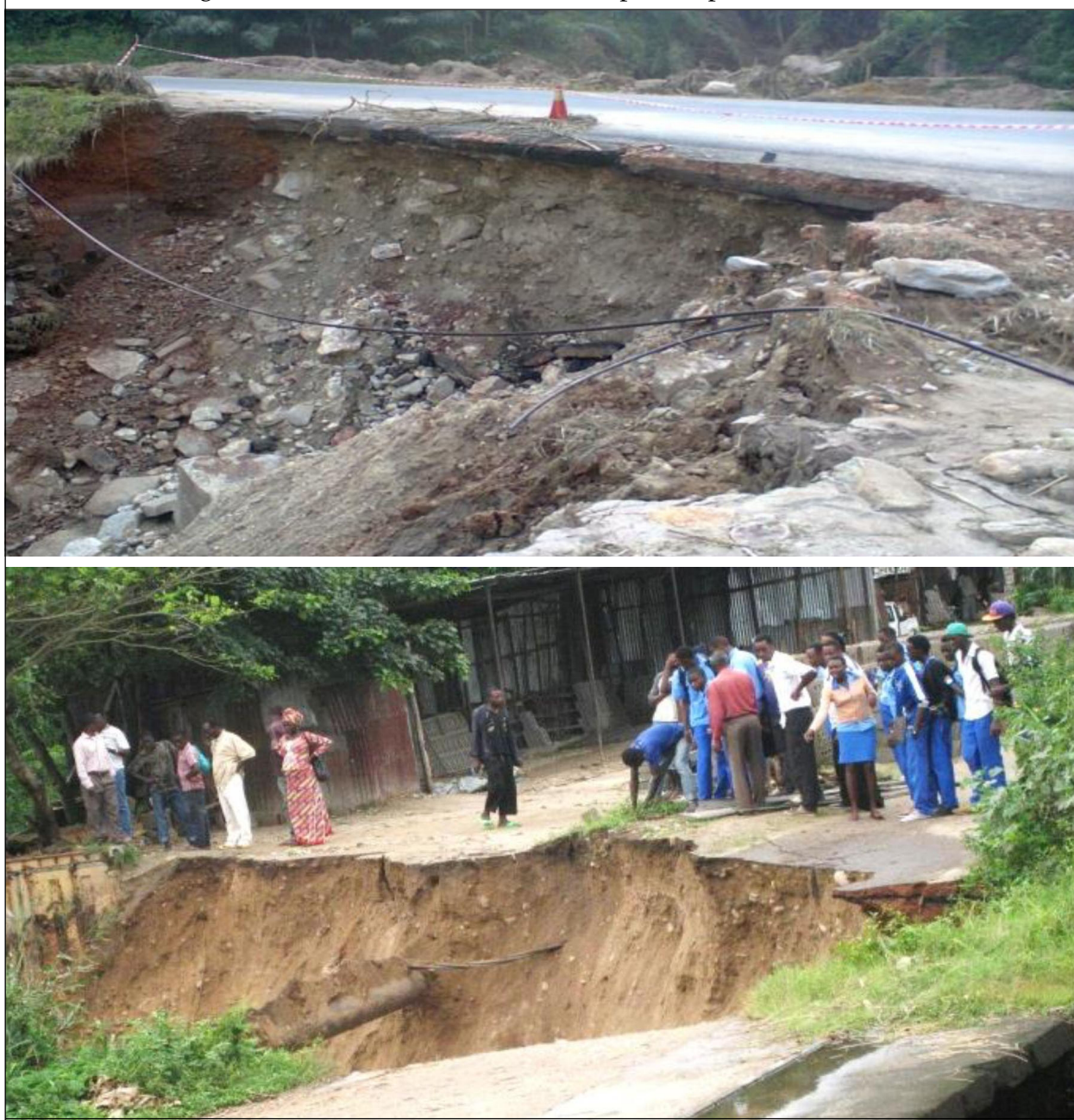
Figure 5: Destruction des routes causée par des pluies torrentielles
